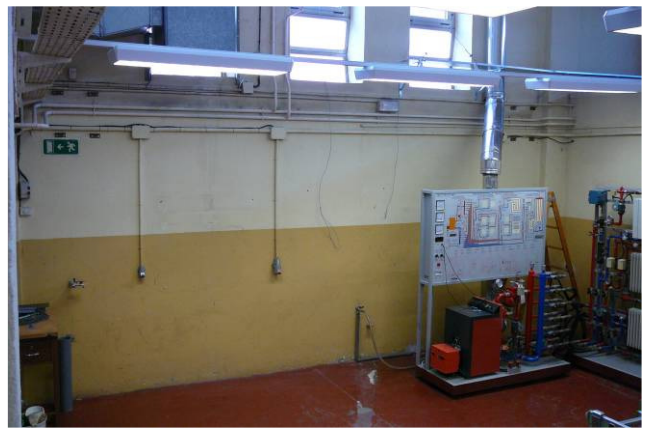
Zona de ubicación interior del resto del equipo
