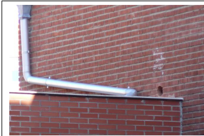
Pared de ubicación exterior del captador
